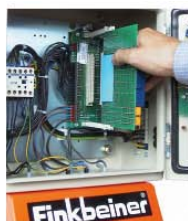
Placas enchufables en cada columna.
